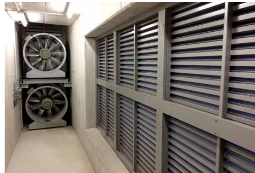
Run- and standby-ventilator aan één zijde middentunnelkanaal.
