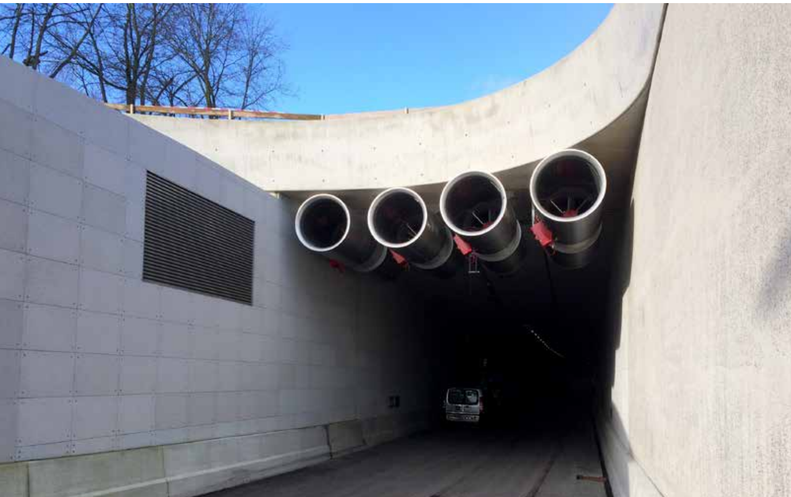
Inlaat overdrukinstallatie Spaardammertunnel.
