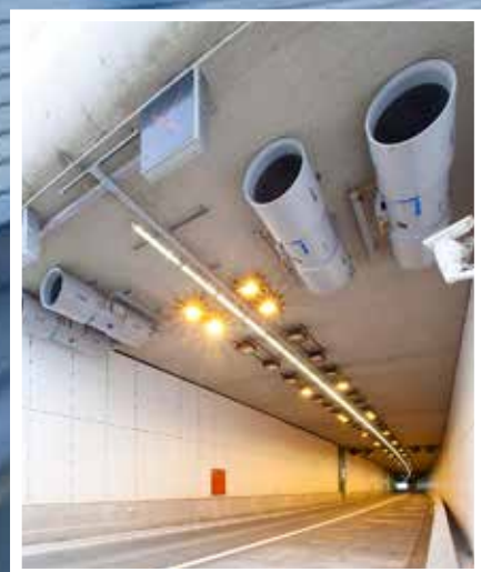
Portaalventilatoren in verkeertunnel.
