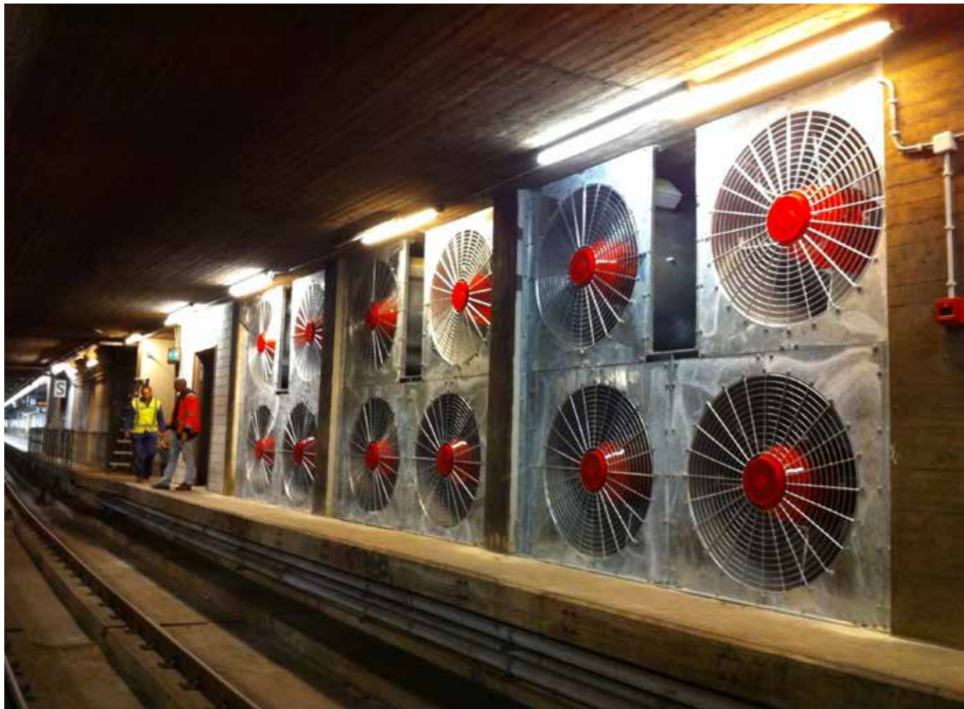
Tunnelventilatie bij RET Rotterdam.
