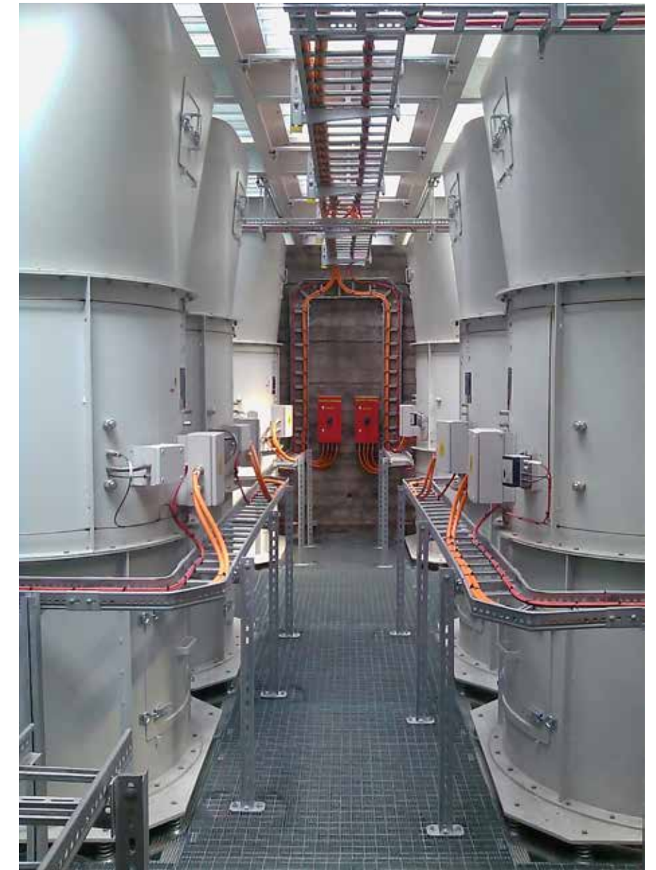
Impressie RWA-ventilatoren opgenomen in bestaande bouwkundige omgeving.
